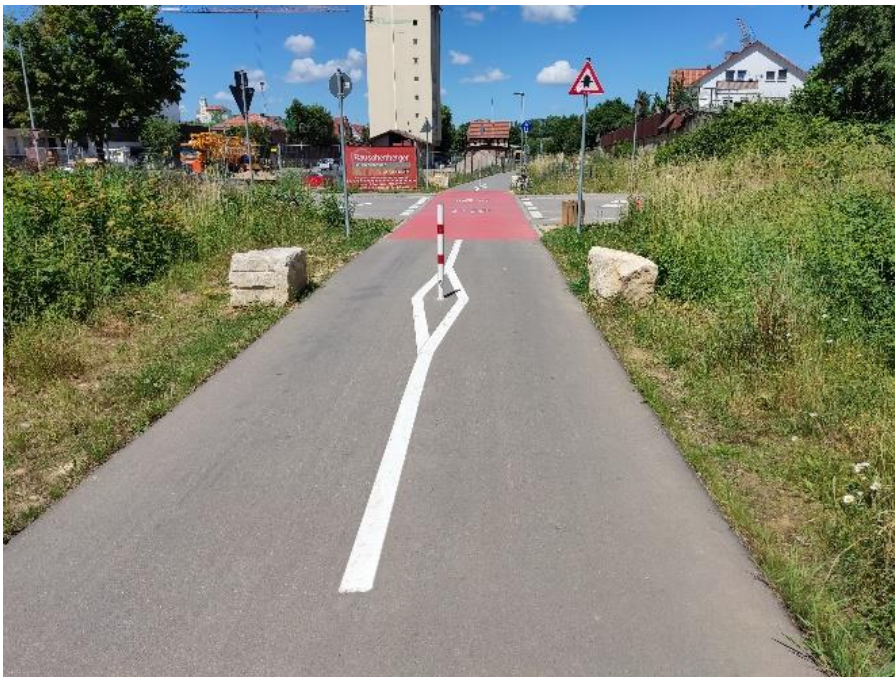
Abbildung 100: Markierung eines Pollers auf einem Radweg mit umlaufender Markierung und retroreflektierendem Material
