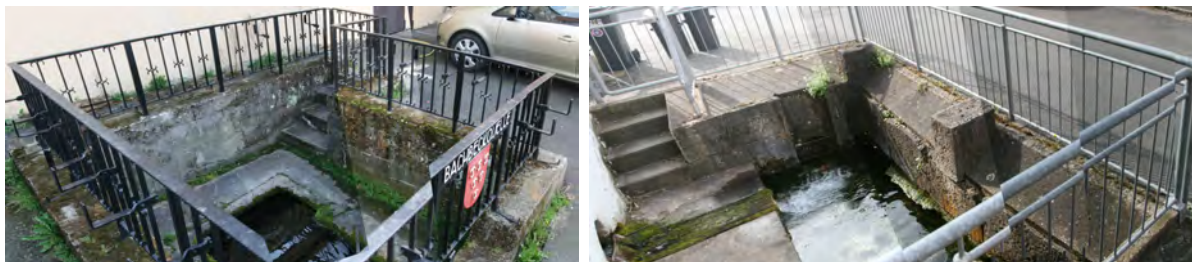
Abb. 67 Blick auf den Einlauf der Bachbeckquelle und der Quelle an der Straßenecke Untere Bachstraße (u.m.s. GmbH)
