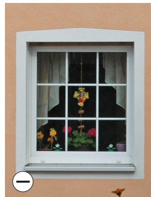
Ungeeignet: Glasgliederung mit eingelegten Kunststoffsprossen
