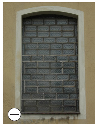
Ungeeignet: Ausfüllen des Lichtausschnitts mit Glasbausteinen
