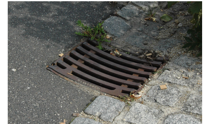
Attraktive Zuordnung eines gusseisernen Straßeneinlaufs zu Fahrweg und gepflastertem Schnittgerinne
