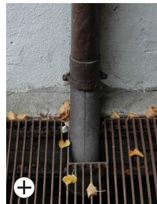
Standrohr aus Metall durch den Straßeneinlauf geführt
