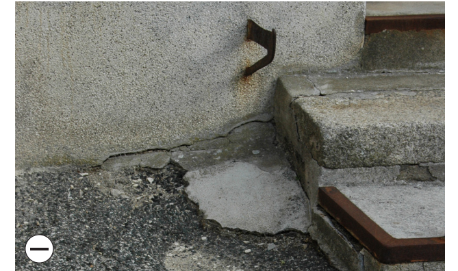
Ungeeignet und eine stetige Gefahrenquelle: Notdürftige Reparatur an einem Hauseingang
