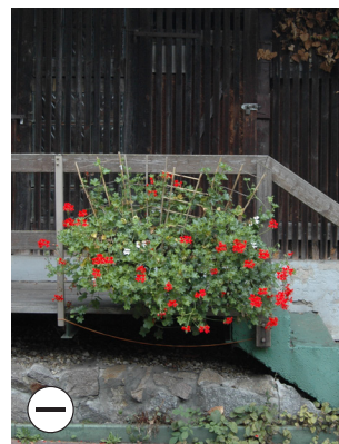
Zum Schutz ungeeignet: Instabile Brüstung aus Brettware
