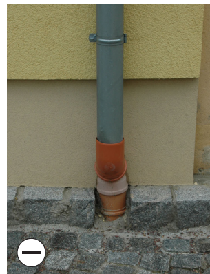
Unzulässig: Standrohr aus Kunststoff
