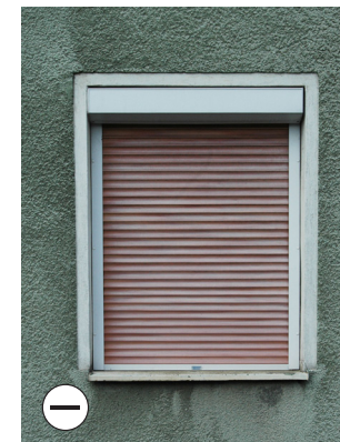
Ungeeignet: Rollladenkasten auf der Außenseite
