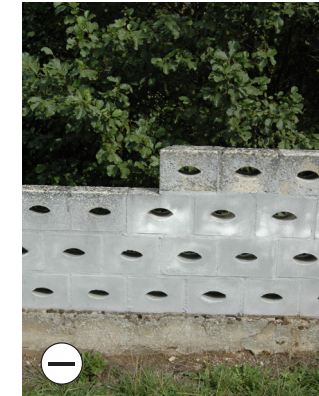
Ungeeignet: Einfriedung aus Betonformstein auf Massivsockel
