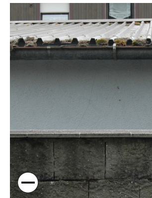
Ungeeignet: Abdeckungen mit profilierten Metallblechen
