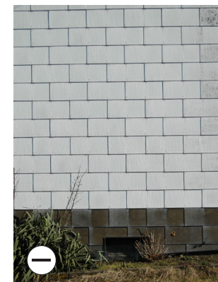
Unzulässig: Wandverblendung eines Hauptgebäudes
