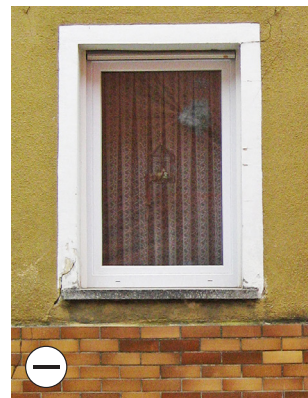
Ungeeignet: Sockelverblendung mit Keramikplatten
