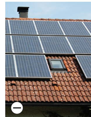
Ungeeignet: Solarmodule mit silberner Metalleinfassung und Aussparungen
