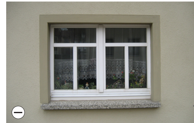
Unzulässig: Breit lagernde Fensterfläche mit aufgesetzten Gliederungsprofilen.
